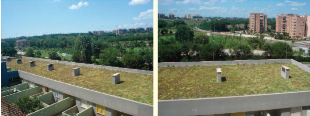
Fig. 5-6. Verde pensile estensivo per la soluzione di copertura del livello residenziale, per complessivi 1080 mq. circa (ImpreMe Spa; 2012)
