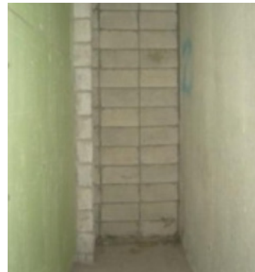
Figura 4.6 Vista del condotto orizzontale di uno scambiatore aria-terra (EAHX/TLVS): estremità del condotto, evidenziando la configurazione costruttiva e la chiusura terminale del sistema.
