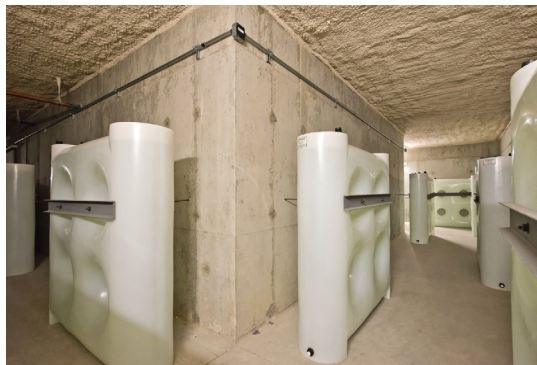
Fig.7 Il labirinto termico si trova nel seminterrato del nuovo edificio del pronto soccorso. I contenitori pieni d'acqua aumentano la massa termica accessibile, ma i requisiti sismici hanno ridotto l'efficacia di questi contenitori riutilizzati per la conservazione degli alimenti, poiché erano destinati a essere perpendicolari al flusso d'aria, con l'aria che passava attraverso i fori nelle "fossette"
