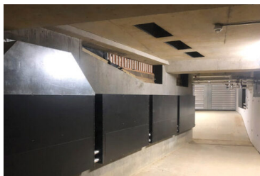
Fig.3 La condotta geotermica ripresa con i convettori statici visibili in primo piano, le serrande modulanti collocate sullo sfondo e, lateralmente, le griglie a parete, mentre a soffitto sono presenti le griglie di mandata a pavimento.
