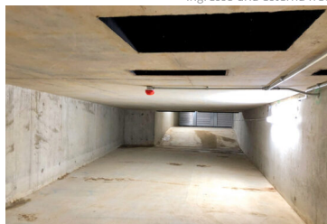
Fig.4 Una delle cinque condotte geotermiche di maggiori dimensioni, realizzata in calcestruzzo.
