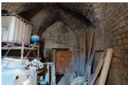
22. Alatri, palazzo di Gottifredo. Gli ambienti voltati al piano interrato del palazzo
