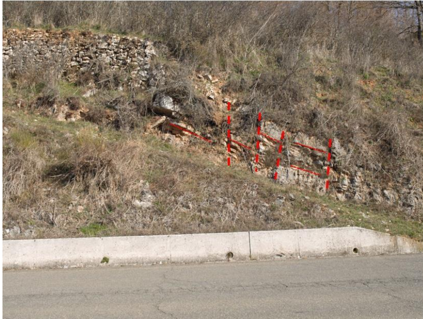
Figura 3.19 Affioramento Z.4 "Moliterno" costituito dalla formazione - SLC2 costituito da strati di micrite grigia fratturata con livelli centimetrici di giallastre. Le linee rosse rappresentano i sistemi di fratture parallele e perpendicolari alla stratificazione S0.
