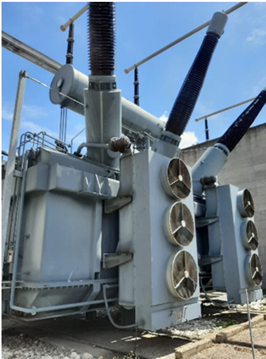
Figura 9.13: Autotrasformatore di stazione da 250 MVA, 400/155±10% kV, 50Hz
