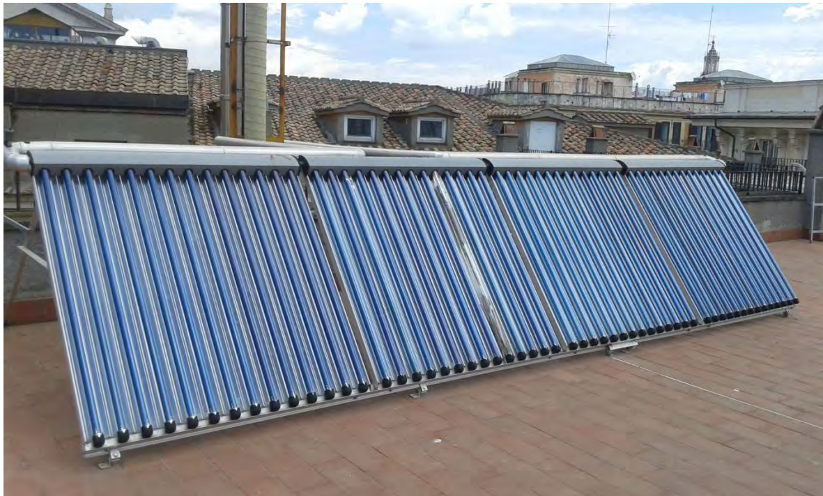
Fig. 8: Collettori solari presenti in copertura
