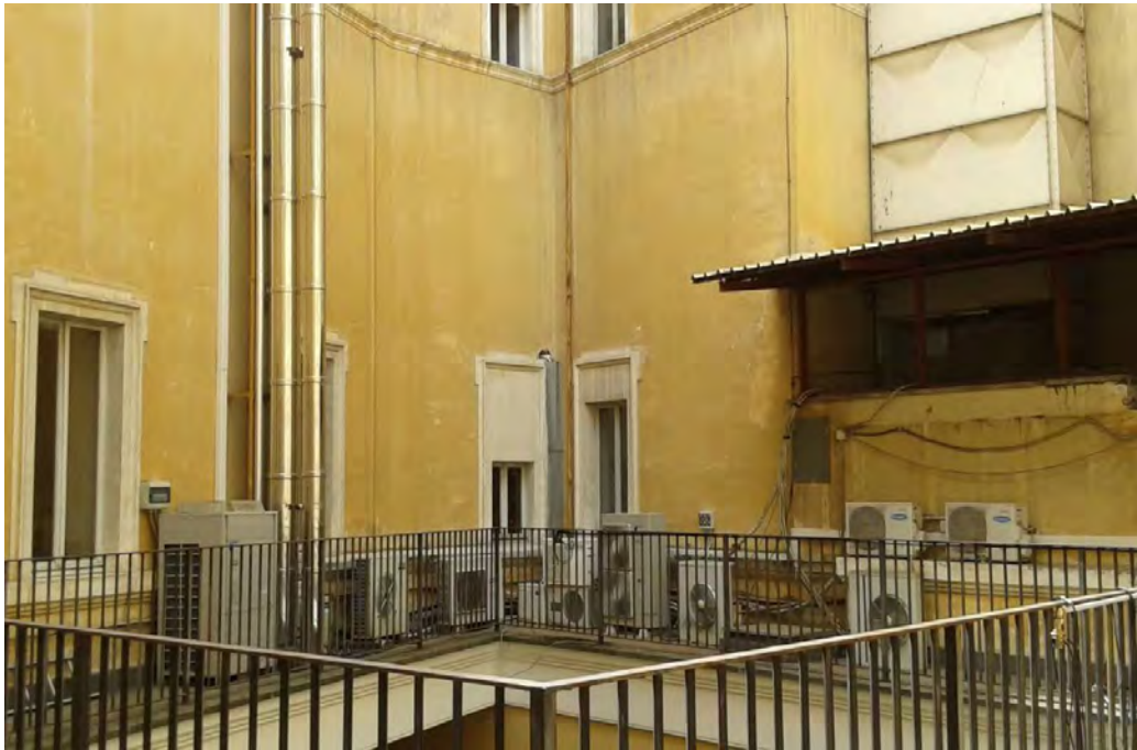
Fig. 6: Unità Esterne climatizzazione
