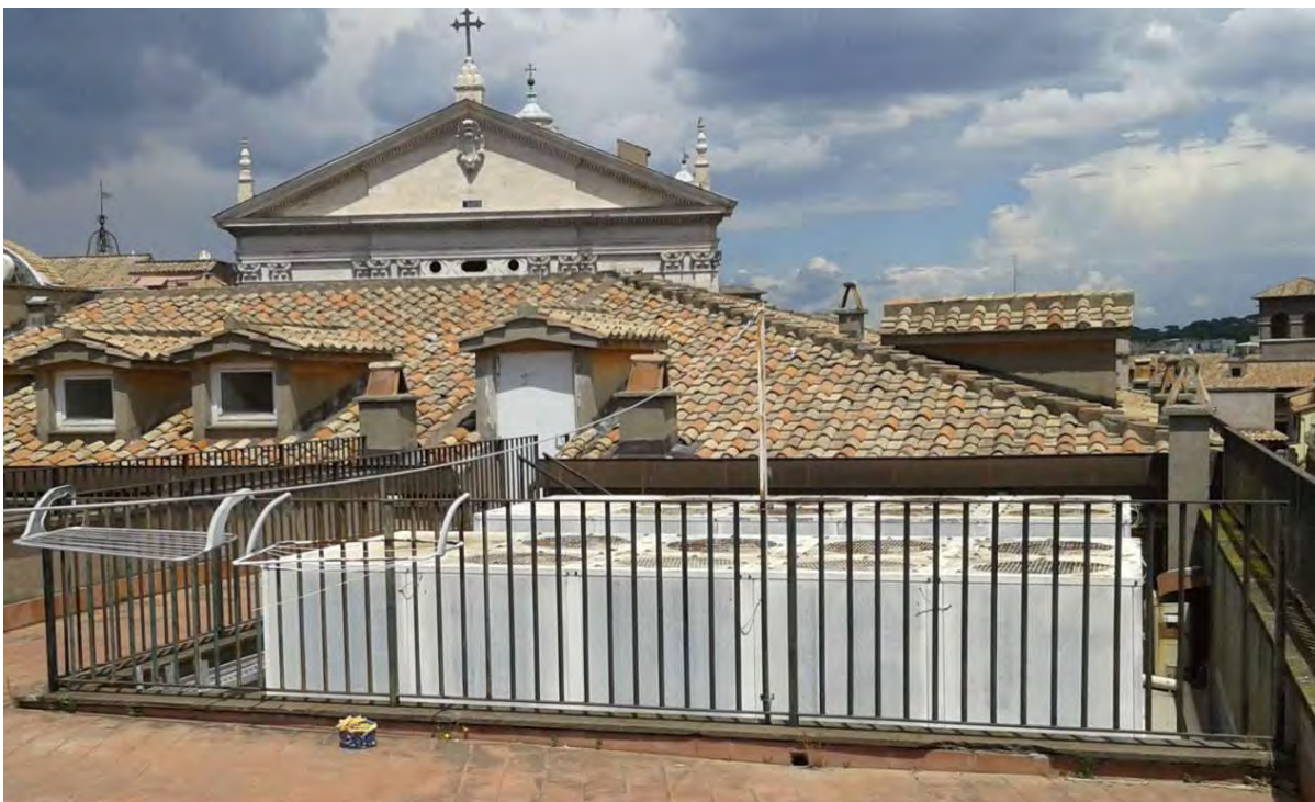
Fig. 7: Chiller dell'UTA presente in copertura
