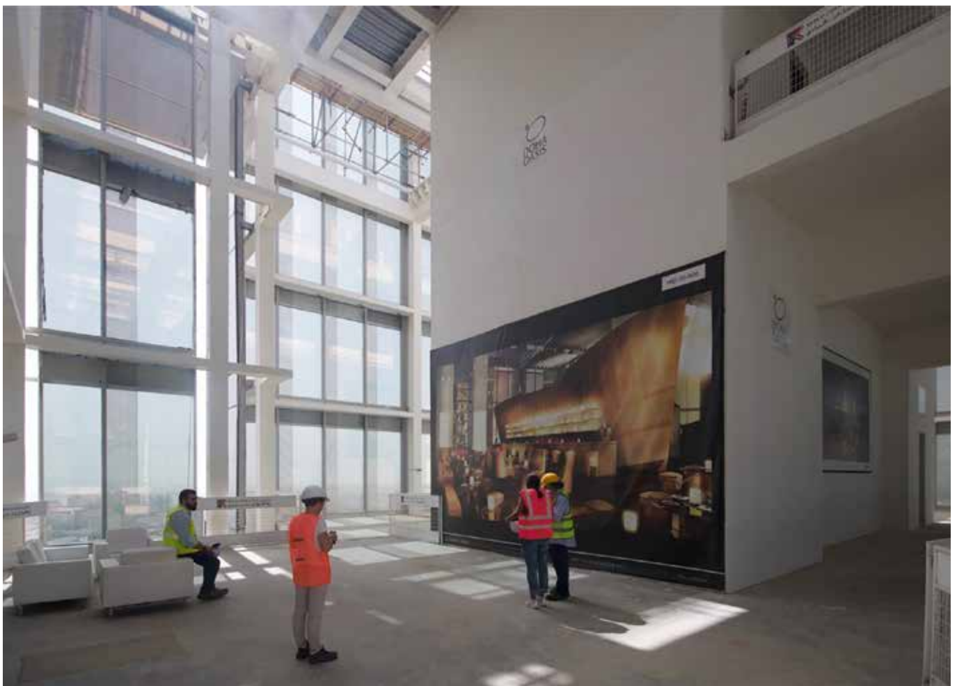
Fig.4 Luogo di intervento: Mezzanino dello SkyView di Doha (foto: Devoto Design).
