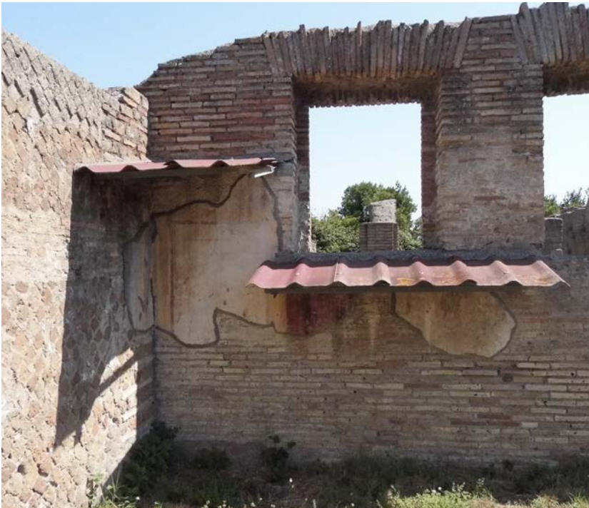
Fig. 3. Alterazione cromatica della tinta legata al soleggiamento e alla cattiva progettazione dei sistemi di protezione (foto dell'autrice).
