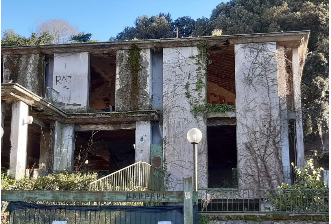
Figura 4. Un edificio abbandonato
