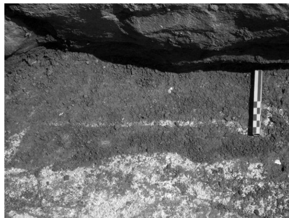
4.12. Caduta di intonaco, con la pittura contro terra, nel vano A1 della Casa dei dipinti.
