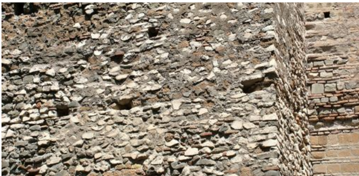
8 Roma, Mura Aureliane, torre L32: elementi di reimpiego in corrispondenza delle buche ponticie.
