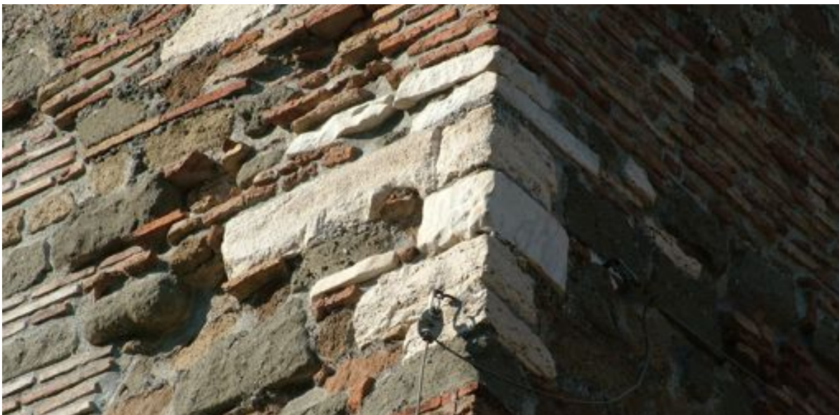
6 Roma, Mura Aureliane, torre L18 (prima metà del XV secolo): elementi di reimpiego inseriti nei cantonali.
