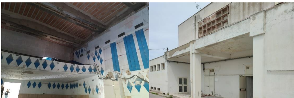
Fig. 10 - Stato di degrado del Cinema Teatro
