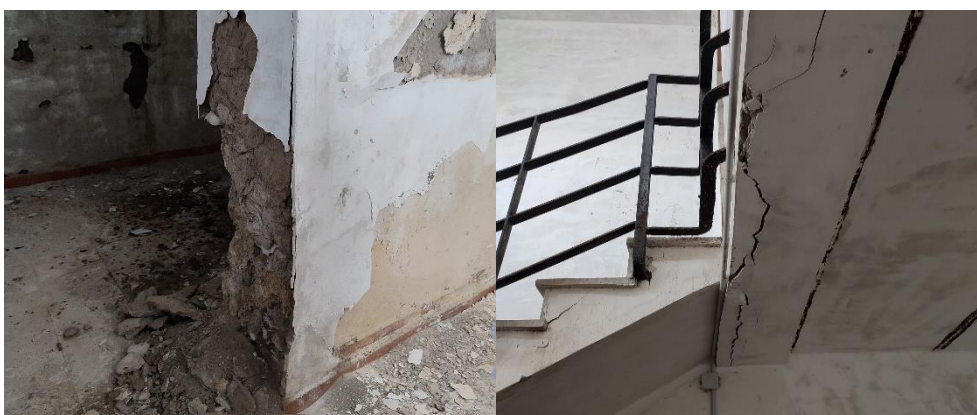
a) Lesioni da compressione sul maschio murario b) Lesioni da torsione e flessione sulle travi
