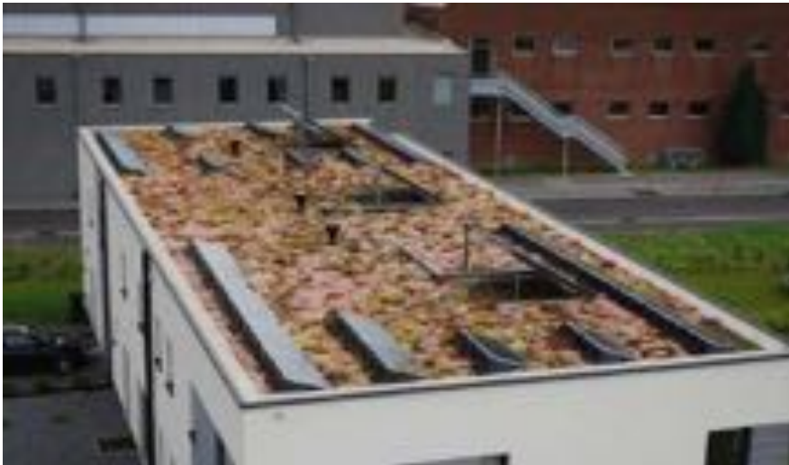
Fig.2: Brown roof con impianto fotovoltaico integrato. Fonte: Construction21.
