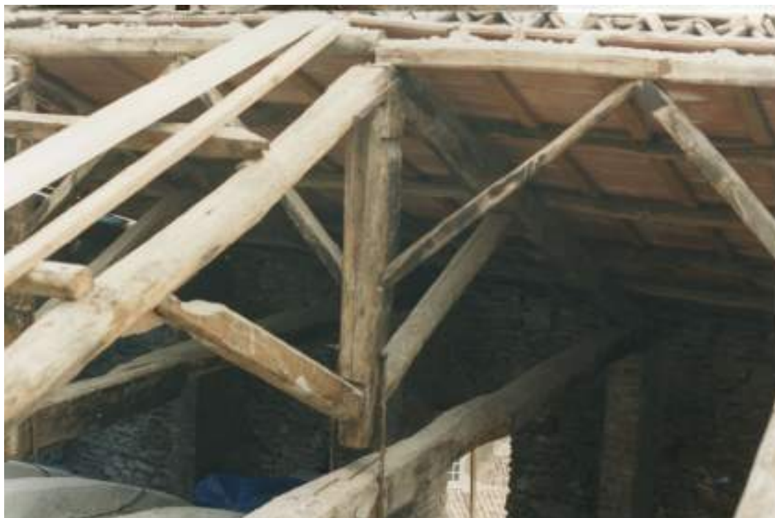
Fig. 44/ Le capriate lignee con saette fuori dal piano, prima di essere eliminate con i lavori di rifacimento della copertura (Archivio Trinchi).
