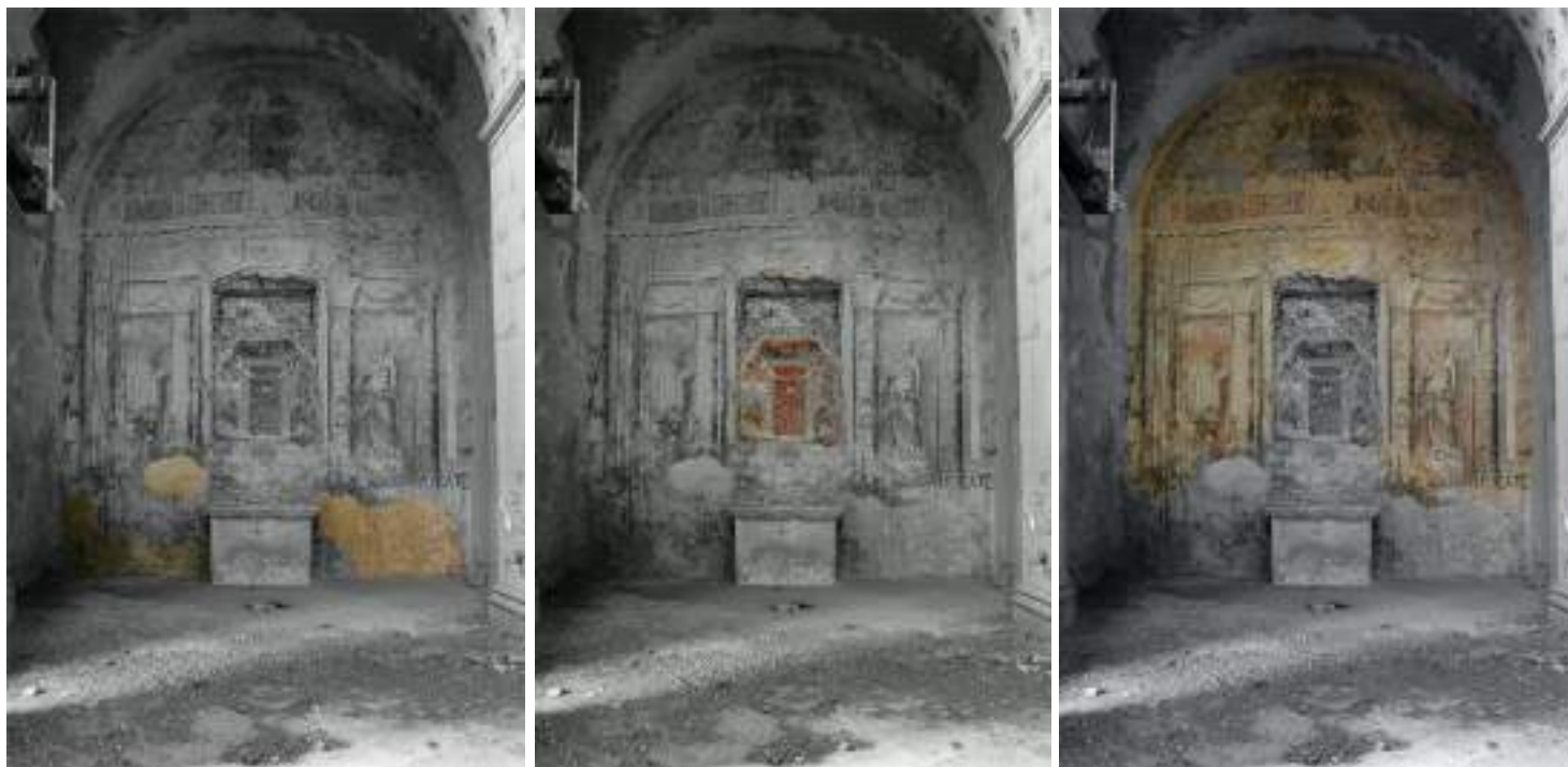
Fig. 8 La prima cappella a sinistra dell'ingresso: i fenomeni di degrado dello strato di finitura mostrano tre livelli di pitture parietali, anziché due come per le altre cappelle.
