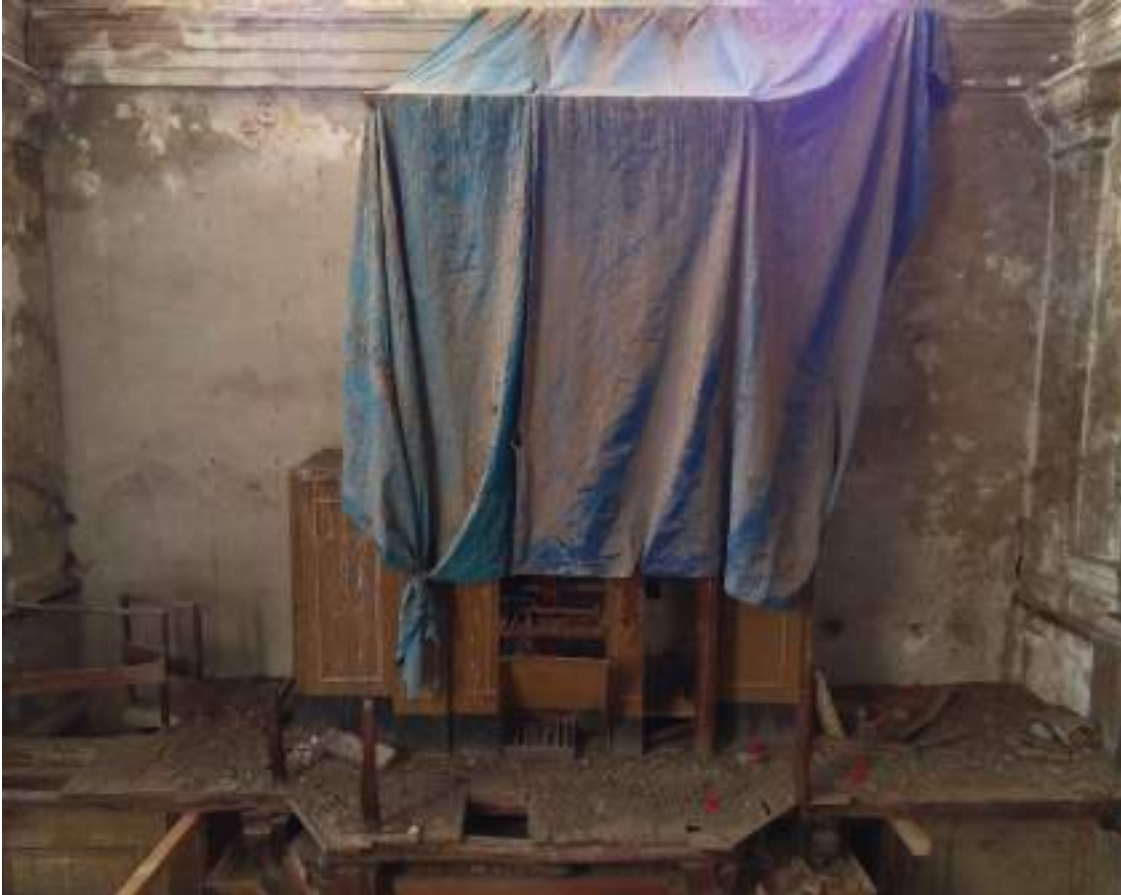
Fig. 5/ Anni 2020-2021: cantoria e organo in forte stato di dissesto e degrado. Vista acquisita durante la campagna di rilievo fotogrammetrico aereo.
