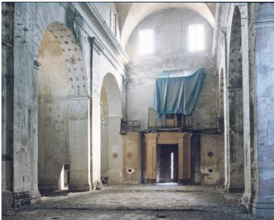
Fig. 4/ Anni 2012-2013: vista della controfacciata con la cantoria e l'organo. A terra, vista del pavimento della chiesa e dell'accumulo di guano in corrispondenza dei tiranti ancorati da pilastro a pilastro, trespoli per i volatili.
