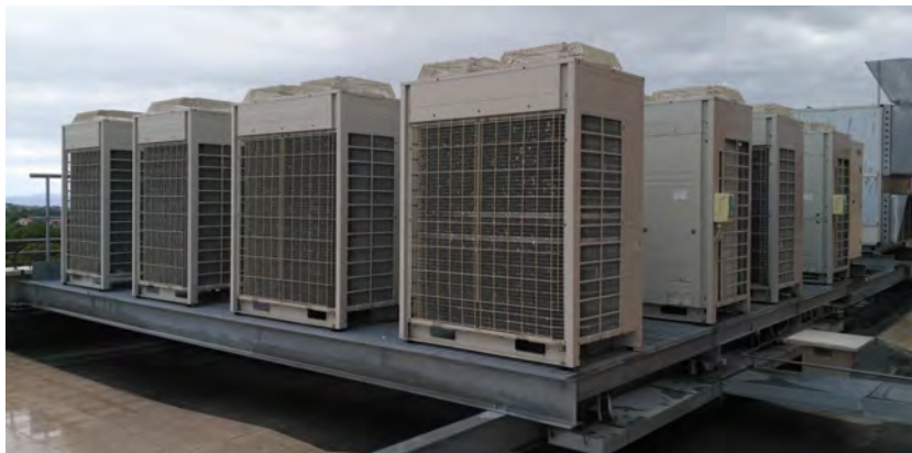
Figura 37 – Unità esterne in copertura dell'edificio "A". Si rimanda all'elaborato grafico progettuale dell'impianto.
