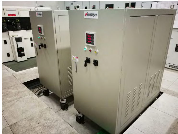
Figura 44 – ENERKEEPER: esempio di installazione in cabina di trasformazione MT/bt
