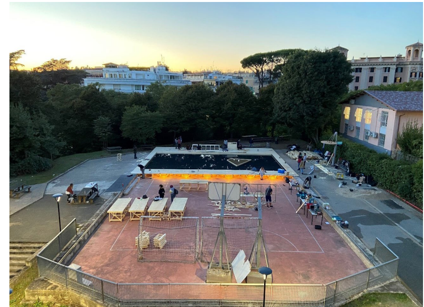
Figura 66. AIM - Architettura In Mobilitazione e Orizzontale. Workshop CENTO. Ultime fasi del cantiere. Foto dell'autrice
