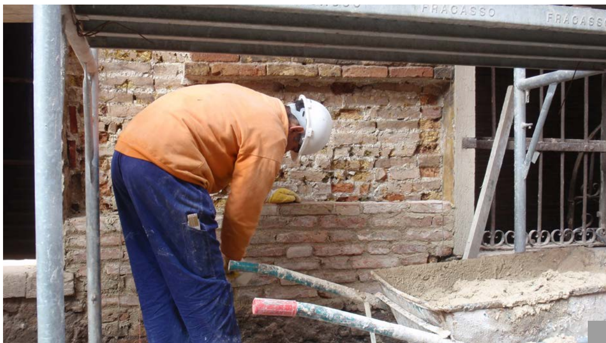
3. Intervento di scuci-cuci di muratura con mattoni di recupero e malta di calce (foto Manzelle).
