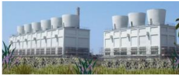
Fig. 35. Impianto di Trattamento Acqua Treno a Nastri (da http://www.bagnolifutura.it )
