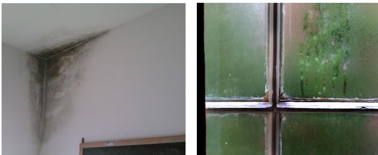
FIG.18 - Formazione di condensa sulla superficie interna(in corrispondenza del nodo tra solaio e parete) e sulla superficie interna vetrata di un infisso;
