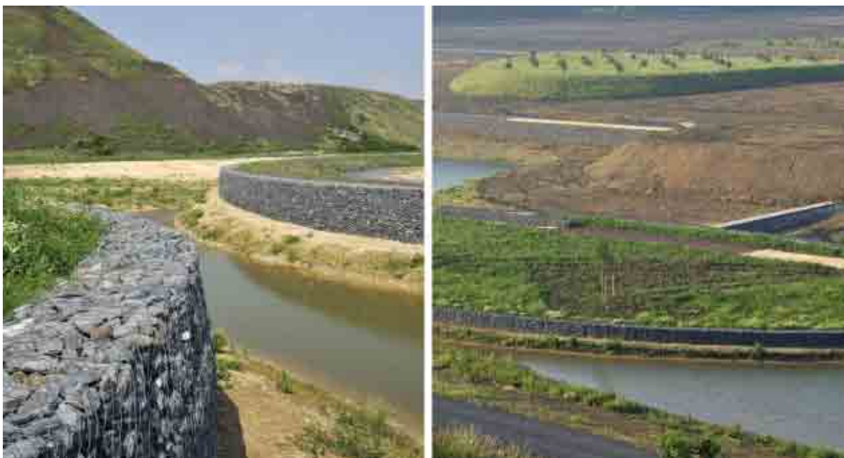
Fig.D5- 11-12: Foto delle vasche e dei muretti a gabbioni di contenimento durante la realizzazione
