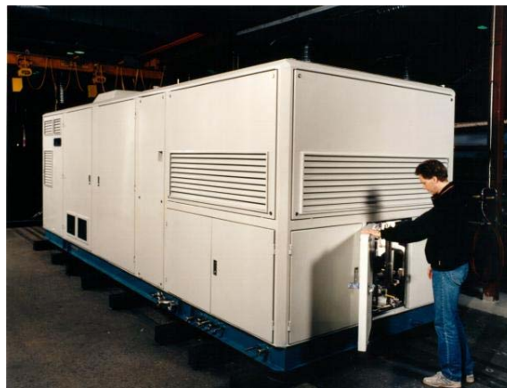
Fig.10. - Unità di cogenerazione on-site da 250 kW di produzione Ballard (Canada)
