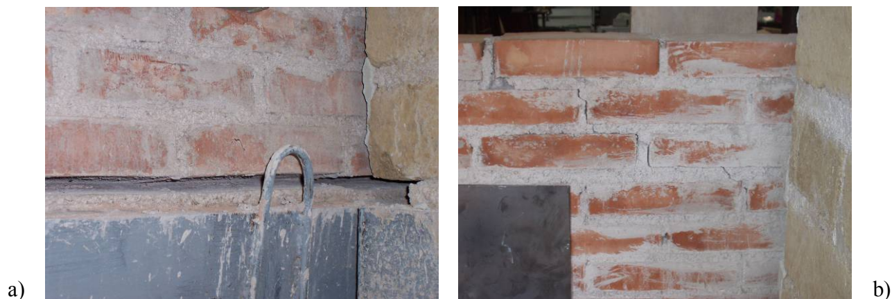
Figura A-15. a) Lesione della cerniera di base aperta; b) danneggiamento dell'angolo superiore della facciata in corrispondenza del muro trasversale.
