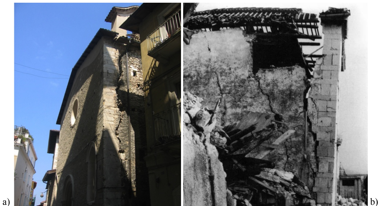
Fig. 1-2 Danni dopo il terremoto, collasso fuori del piano: a) San Giuseppe dei Minimi, dopo il sisma del aprile 2006; b) Santa Maria del Fossale a Gemona (UD), dopo il sisma del maggio 1976.
