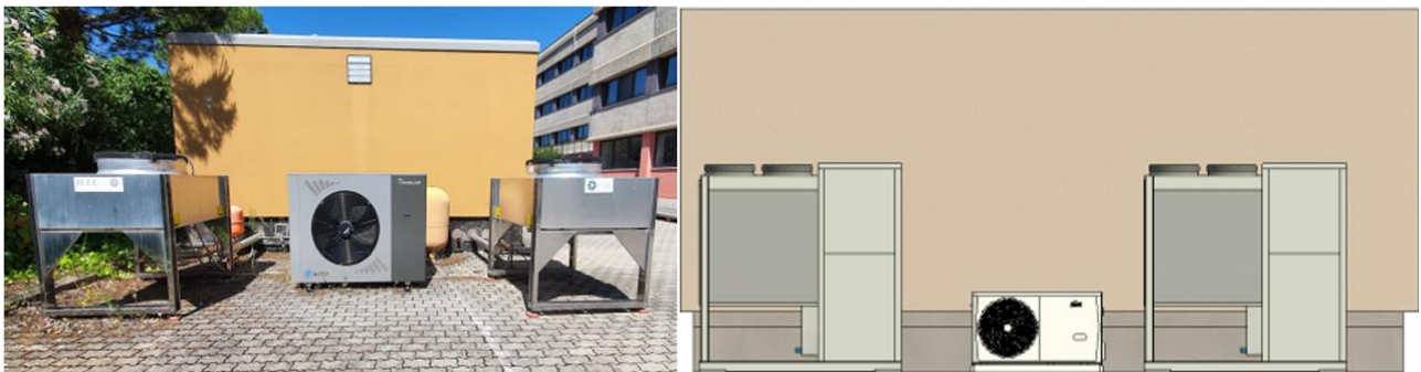
Figura 112 Confronto digital twin-reale dry cooler e pompa di calore
