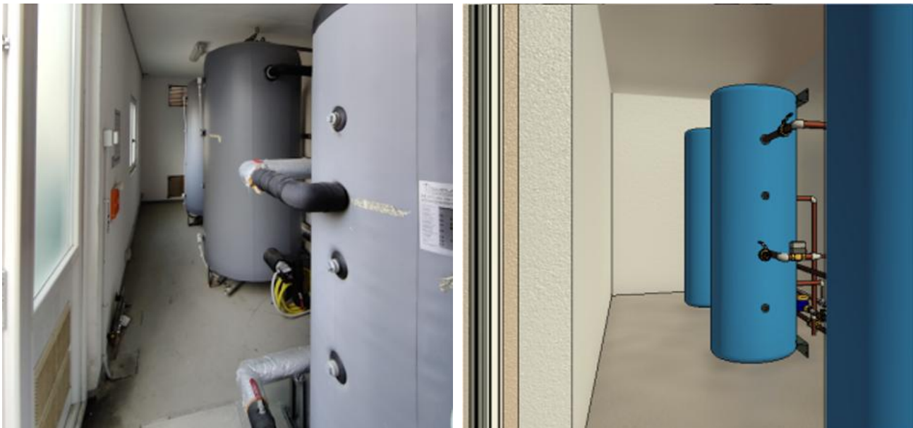
Figura 113 Confronto digital twin-reale cabina impianto termico
