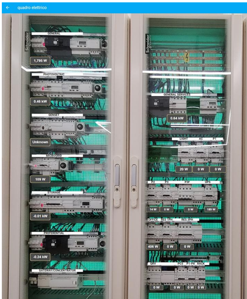
Figura 52 Dashboard del quadro elettrico generale
