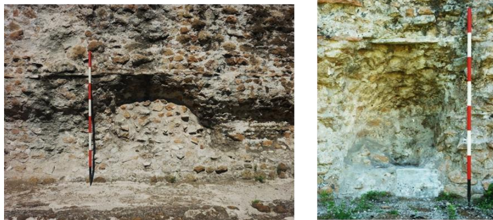
Figg. III.52 a-b: Blocchi di rivestimento del mausoleo. A sinistra un foro da asportazione restaurato. A destra la coda di un blocco in marmo proconnesio ancora in situ (Foto R. Santarelli 2023).
