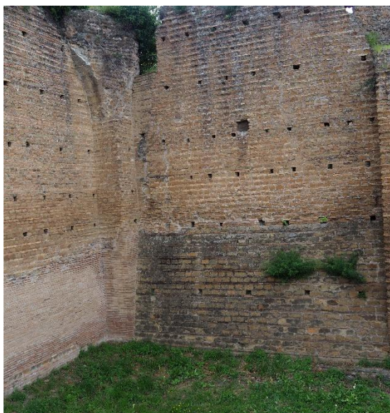
Fig. III.42: Angolo nord. Dettaglio dello sperone di rinforzo del muro (Foto R. Santarelli 2024).
