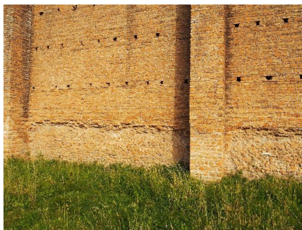
Fig. III.22: Quadriportico. Particolare della parte inferiore del lato sud-orientale. Lacuna risarcita con dei restauri, che prosegue su tutti i lati della struttura (Foto R. Santarelli 2025).
