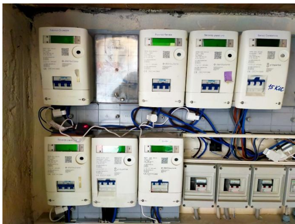
Figura 68. Esempio di misuratori installati in un condominio
