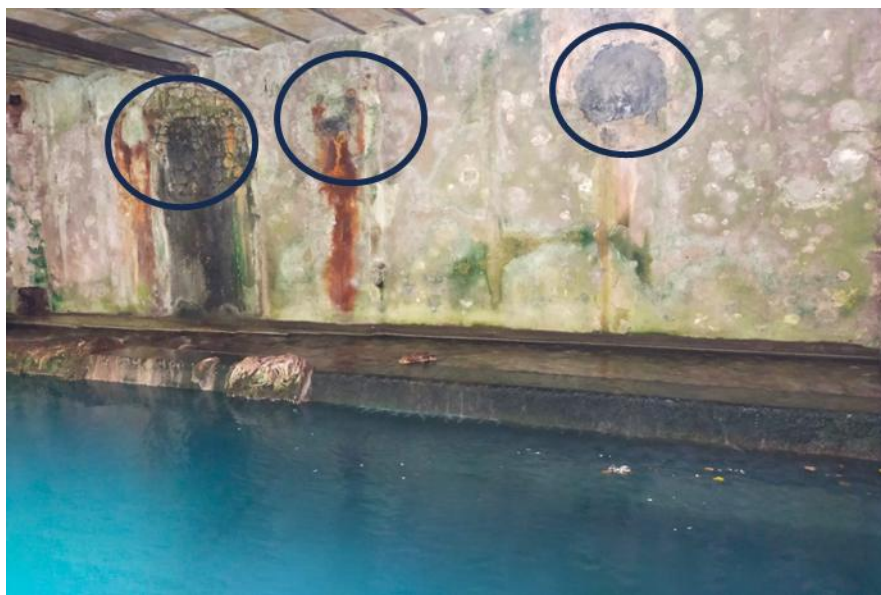
Figura 97. Disposizione primordiale delle turbine nel locale macchine sito al piano inferiore della storica centrale Netti
