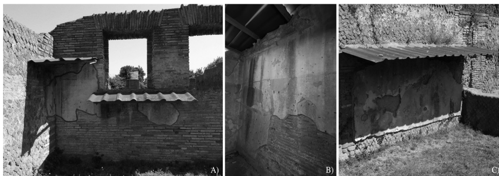
Fig. 8. Esempi di degrado legato all'errata progettazione o al malfunzionamento dei sistemi di copertura: A) Dilavamento della tinta in relazione al diverso soleggiamento indotto dalle tettoie protettive; B) Colature con conseguente colonizzazione biologica in corrispondenza delle travi lignee di copertura; 3) Erosione legata all'azione del vento incanalato dal sistema di protezione.
