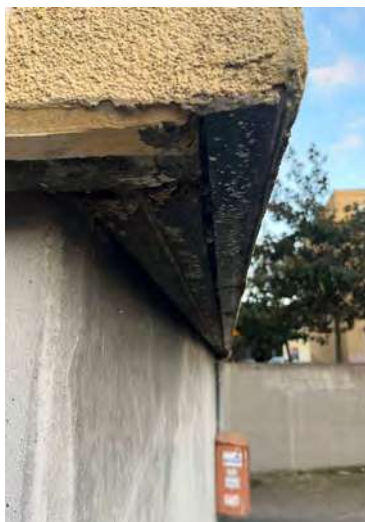
Figure 27, 28 e 29 | Quartaccio 2023. Degrado degli elementi tecnologici di facciata
