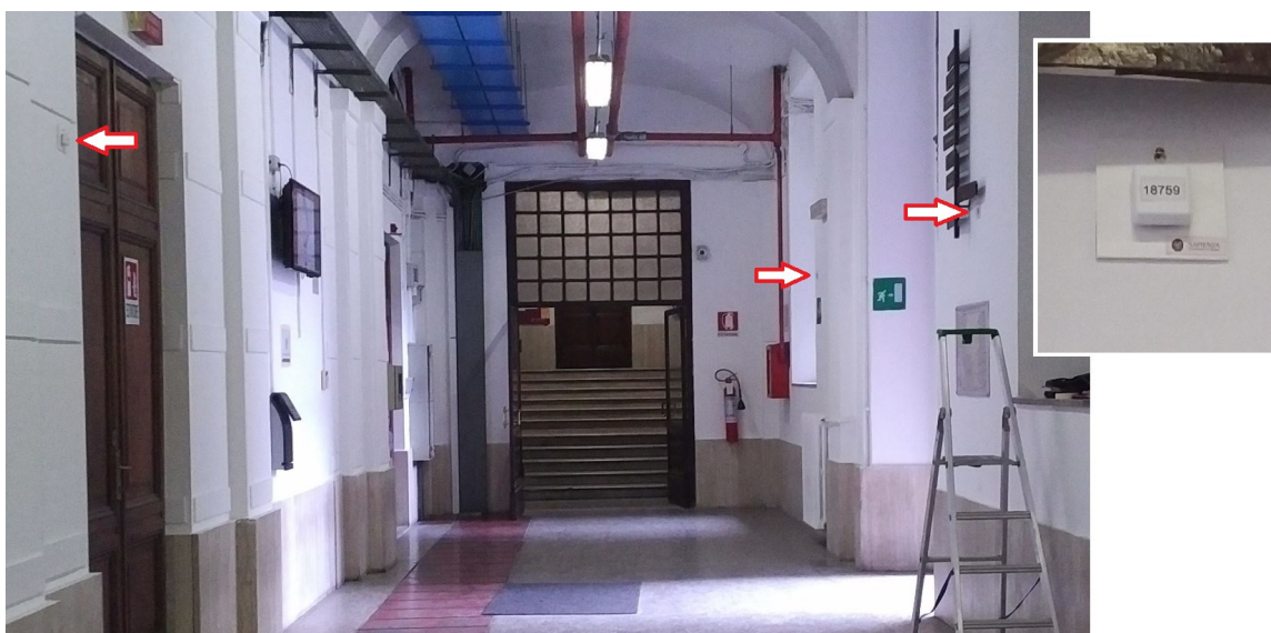
Figura 5.21: installazione dei Beacon a 2.5 m da terra nel locale Sapienza
